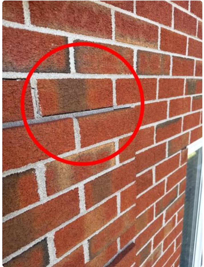
Fissure en escalier façade avant
