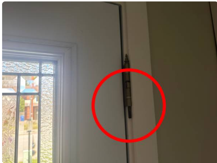
Charnières de la porte d'entrée décalée
