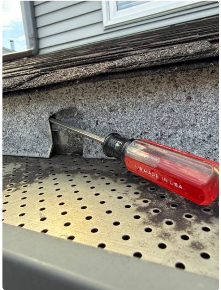
Ouverture mal calfeutrée au solin près des gouttières
