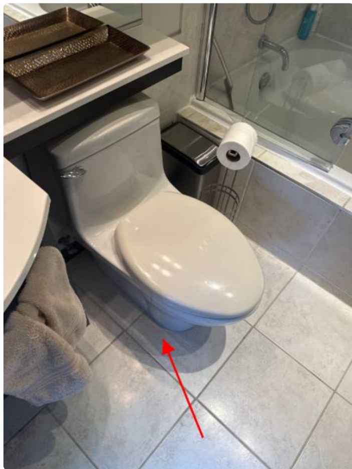
Toilette mal fixé
