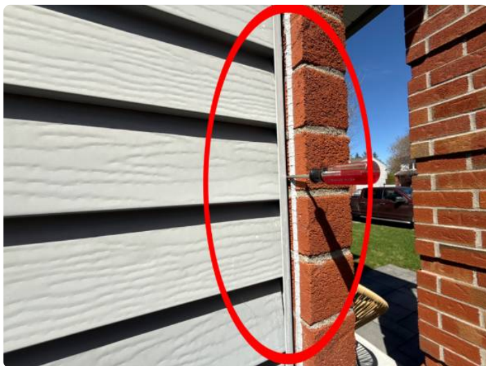
Calfeutrante fissuré et effrité
