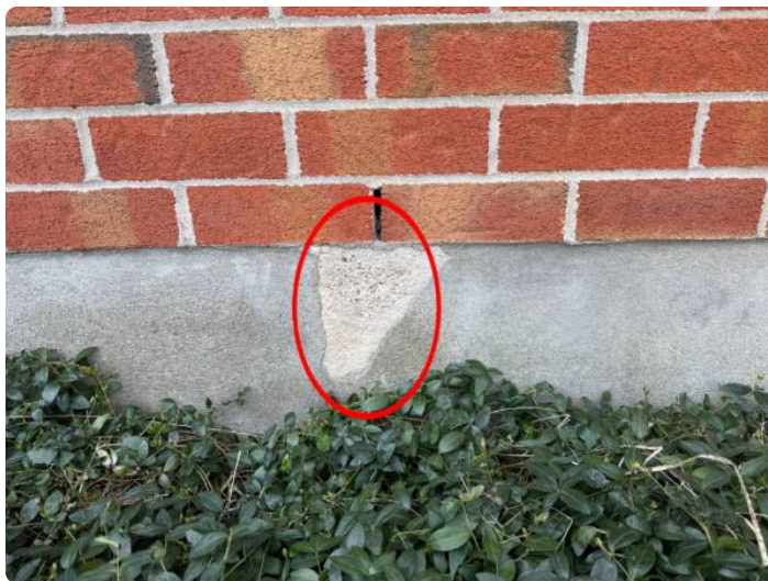
Dégradation du crépi sur la façade avant
