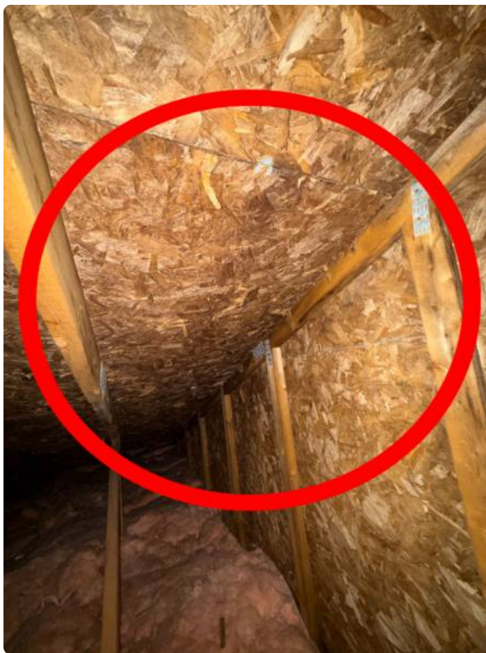
Signes de ventilation insuffisante
