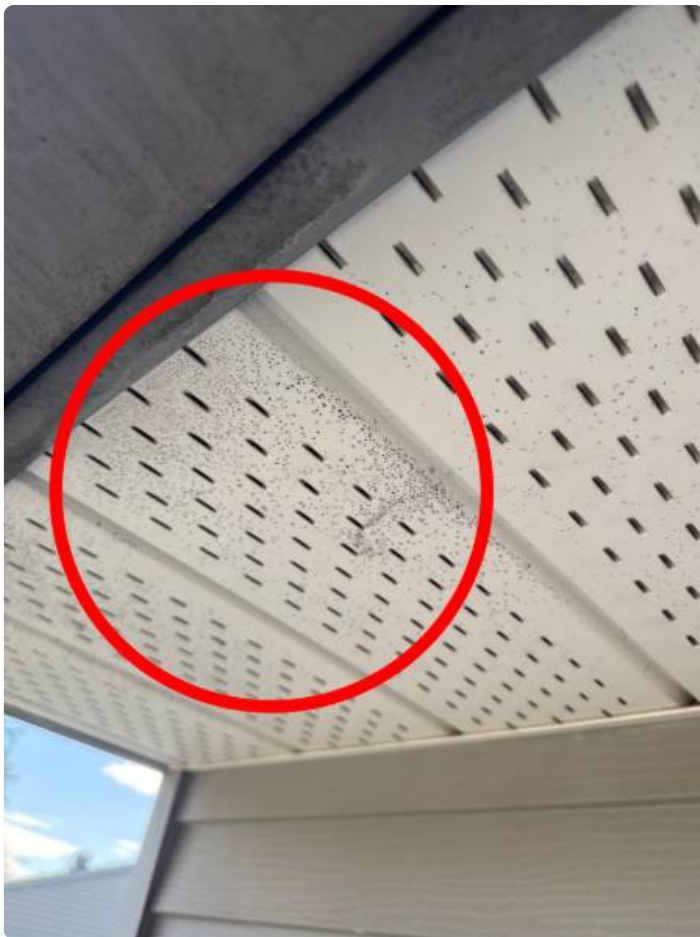
Taches noirs sur les soffites de la façade avant
