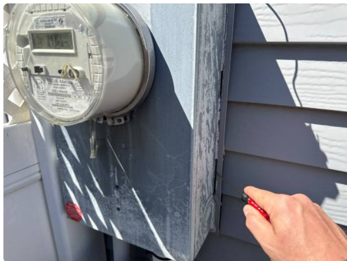
Calfeutrage autour du compteur électrique à reprendre
