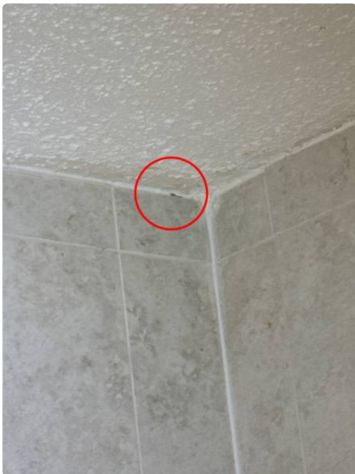
Salle de bain a l'étage - Calfeutrage a corriger
