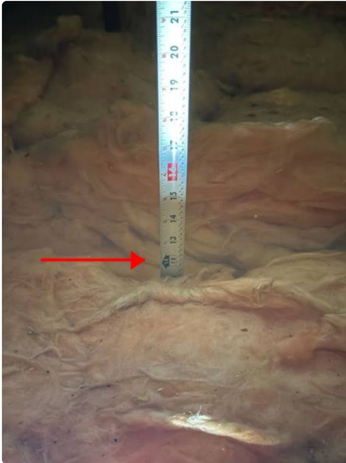
Quantité d'isolant insuffisant
