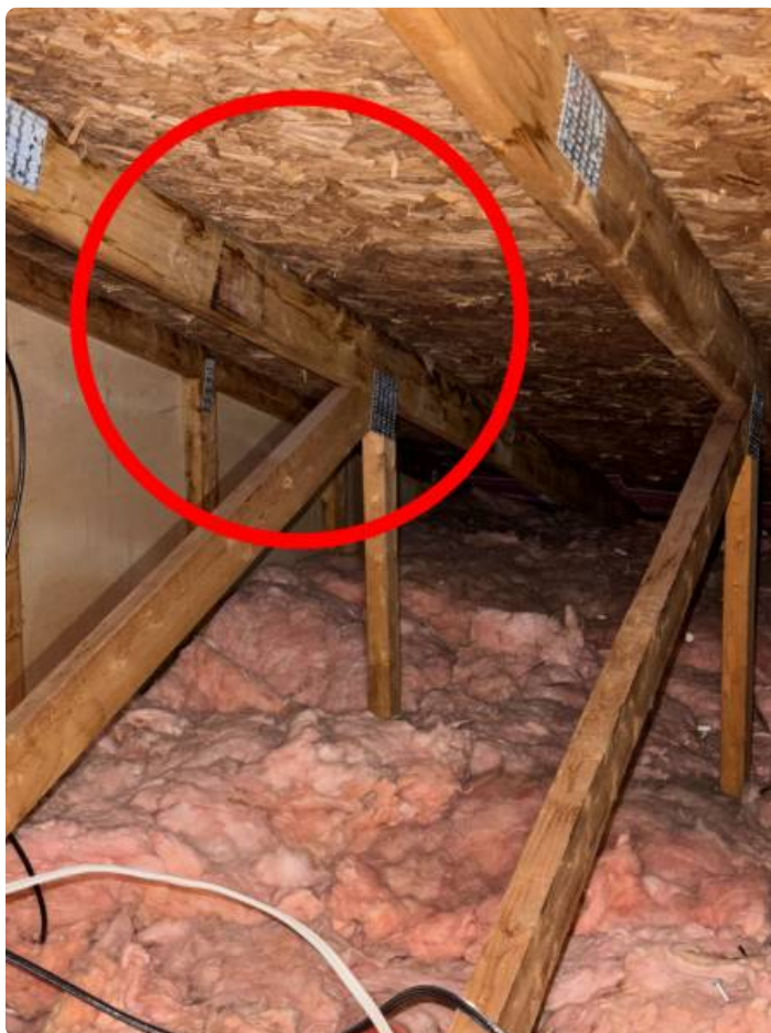
Signe d'infiltration d'eau dans le comble
