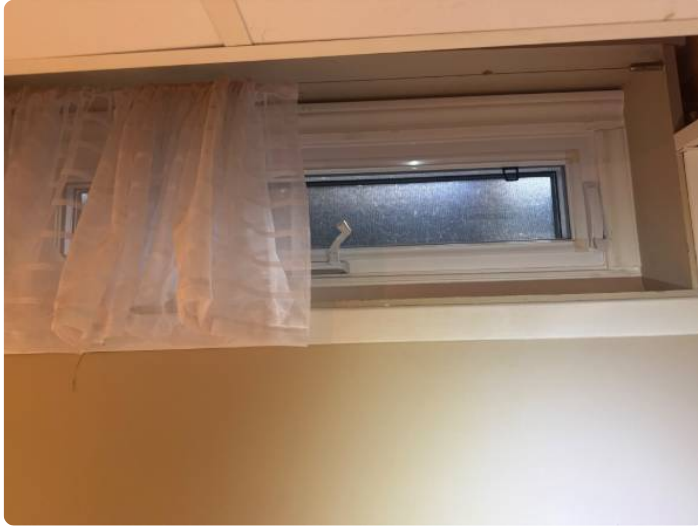
Dimensions des fenêtres de sous-sol inadéquates
