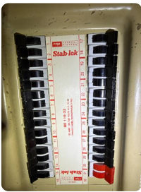
Panneau électrique Stab-Lok
