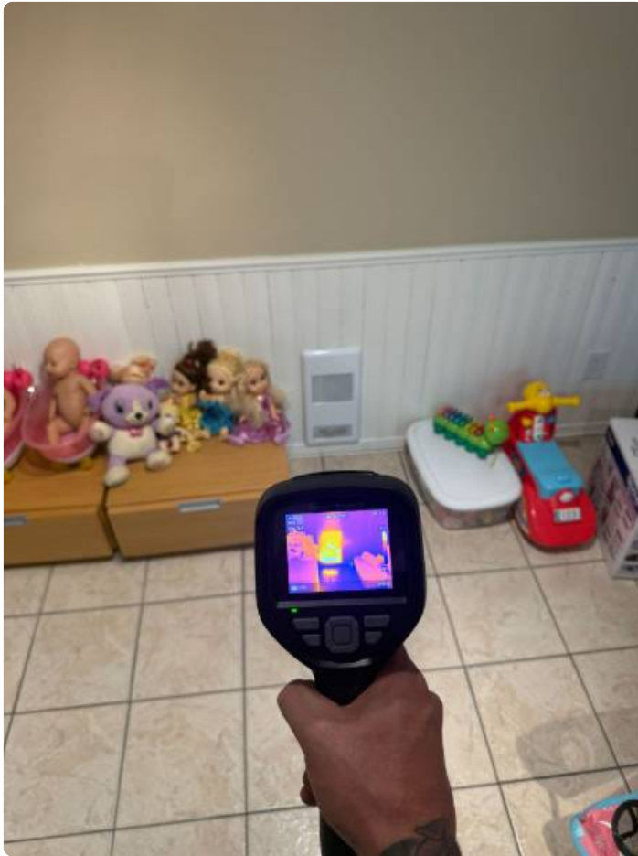
Émission de chaleur observée
