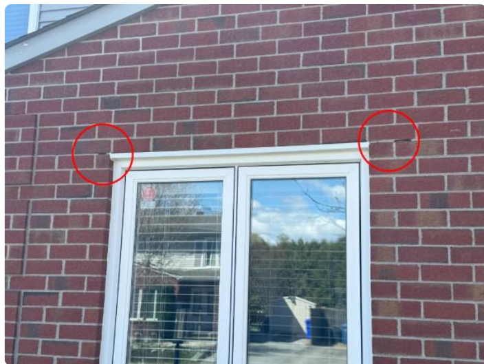
Signes de rouille sur le linteau
