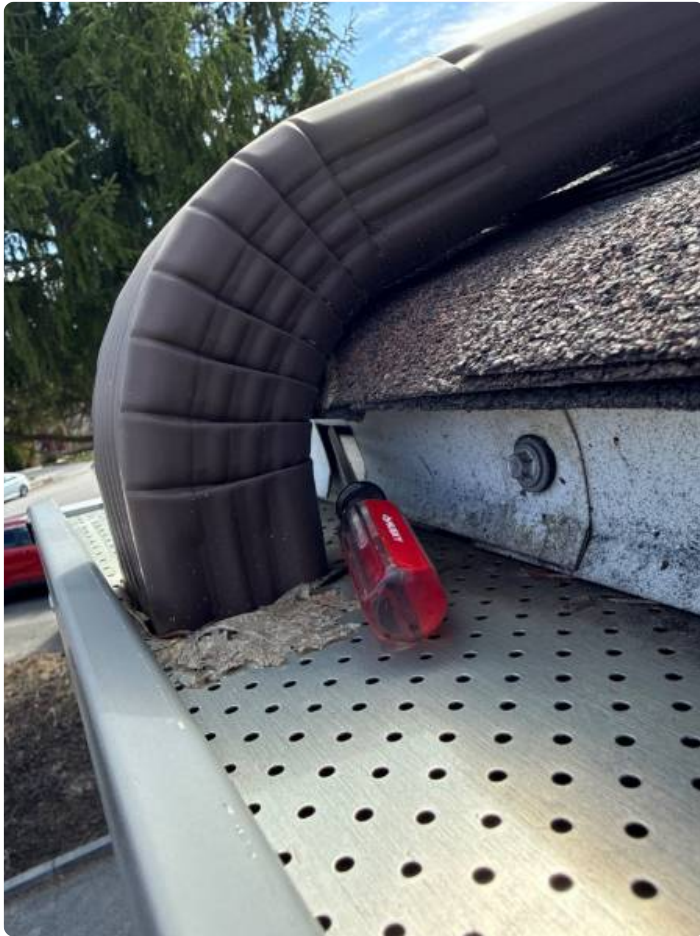
Ouverture mal calfeutrée au solin près des gouttières
