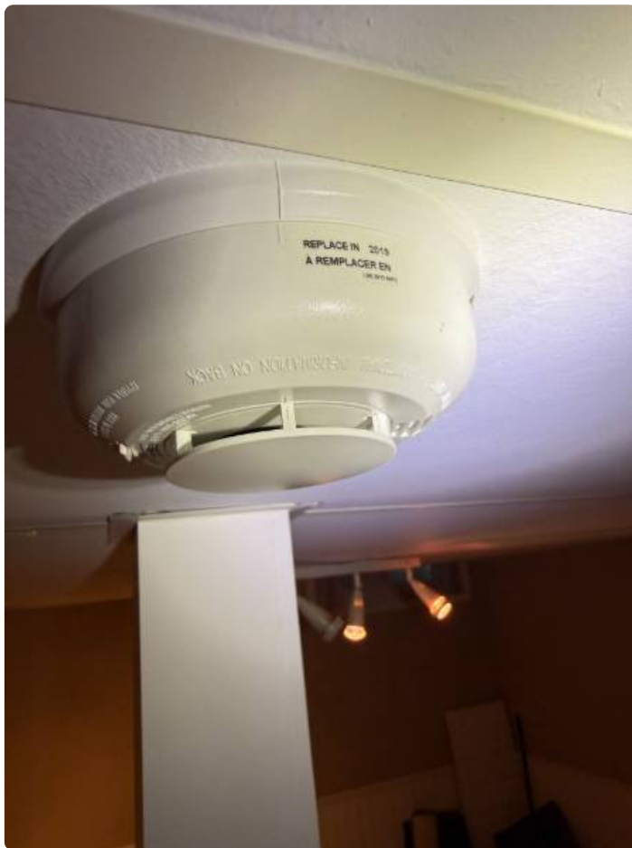
Avertisseur de fumée obsolète
