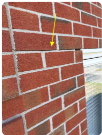
Fissure en escalier façade avant
