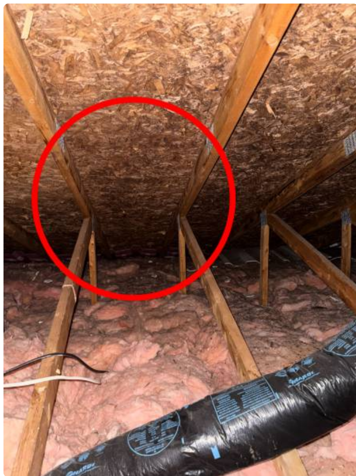
Signes de ventilation insuffisante
