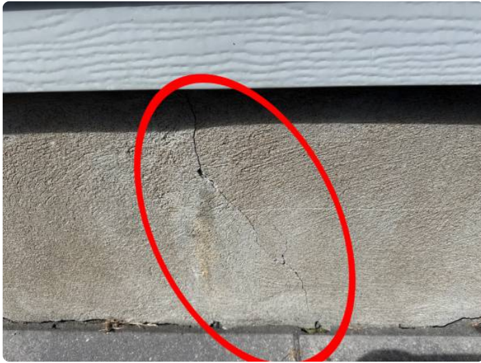
Crépi fissuré coté gauche du bâtiment
