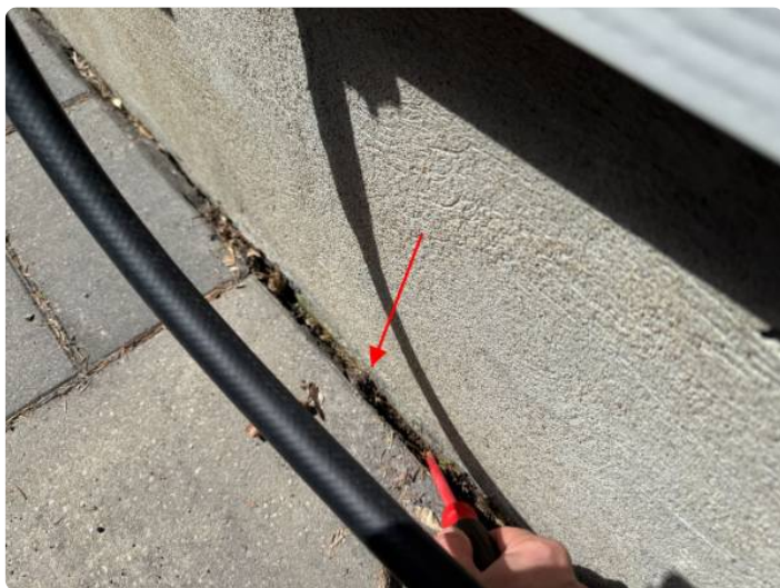
Espacement entre le pierre et la fondation
