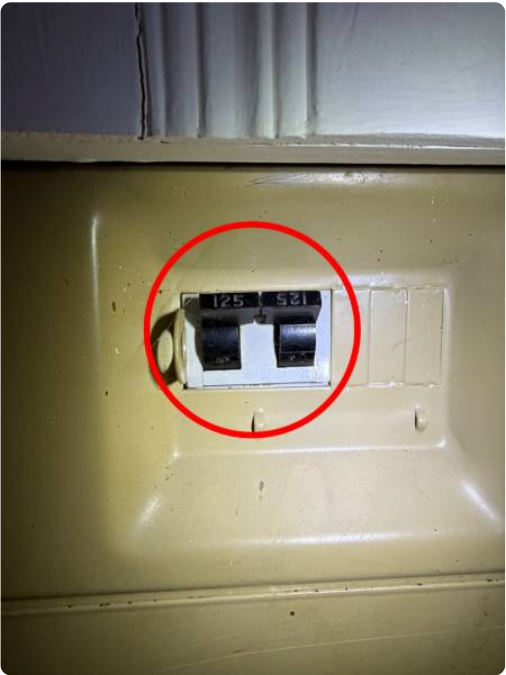
Disjoncteur principale insuffisant
