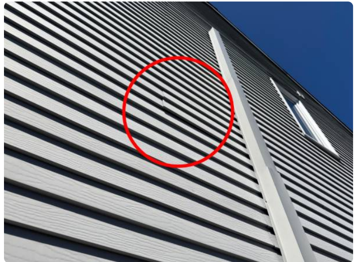
Clin d'aluminium mal jointé
