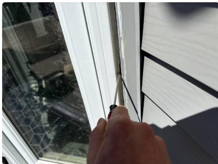
Calfeutrant fissuré et séché
