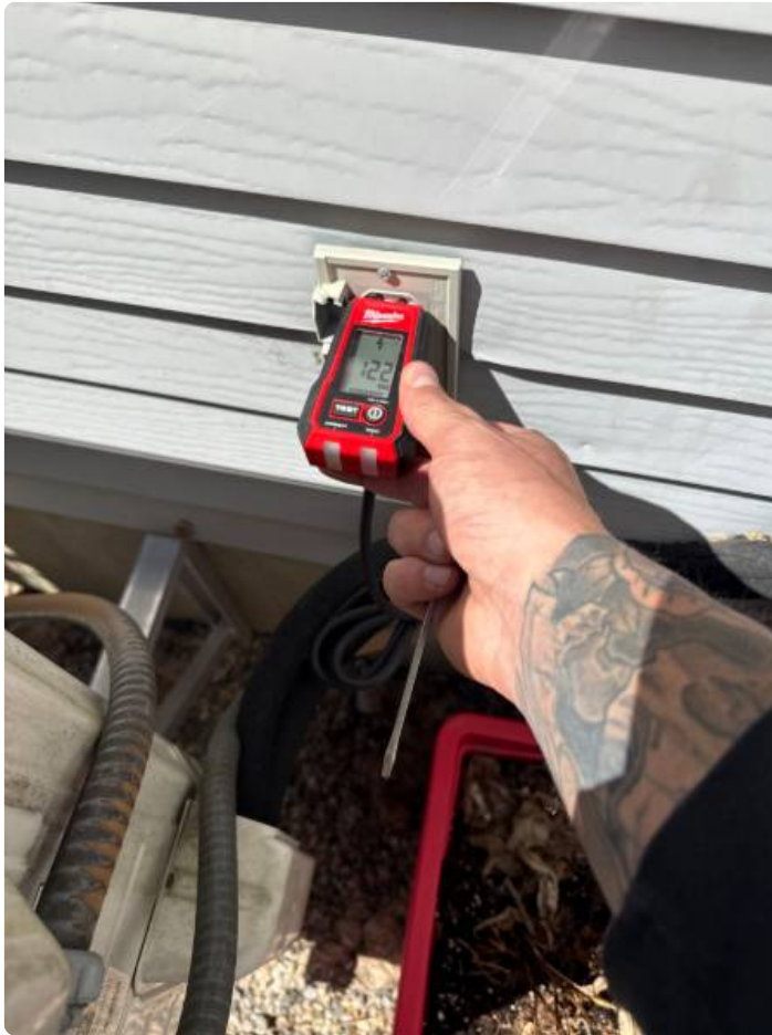
Prise extérieure sans protection DDFT ni boîtier de protection
