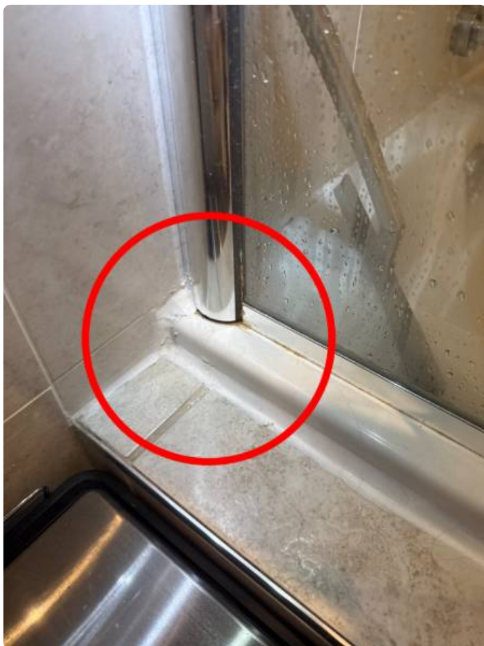
Salle de bain à l'étage - manque de calfeutrant
