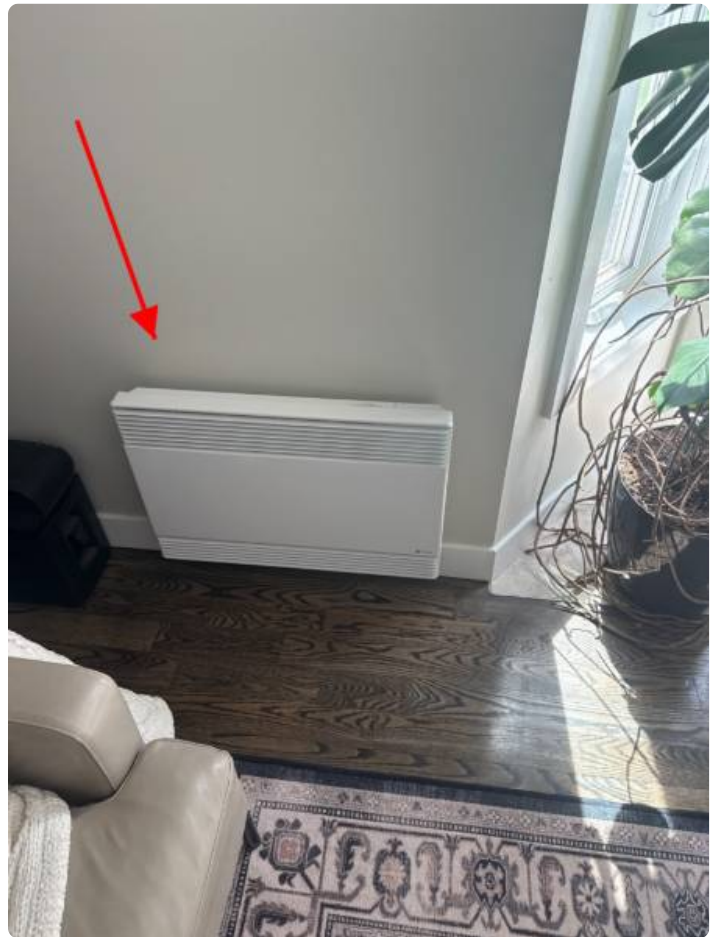
Ancrage manquant ou inadéquat
