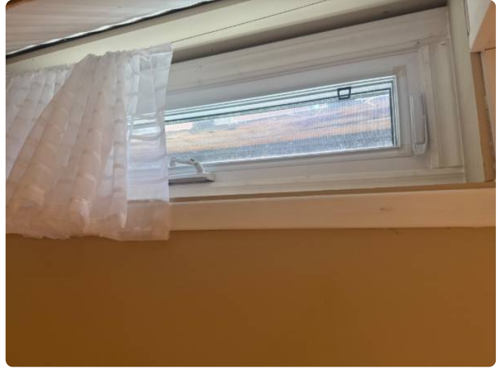
Dimensions des fenêtres de sous-sol inadéquates
