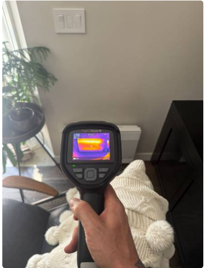
Émission de chaleur observée
