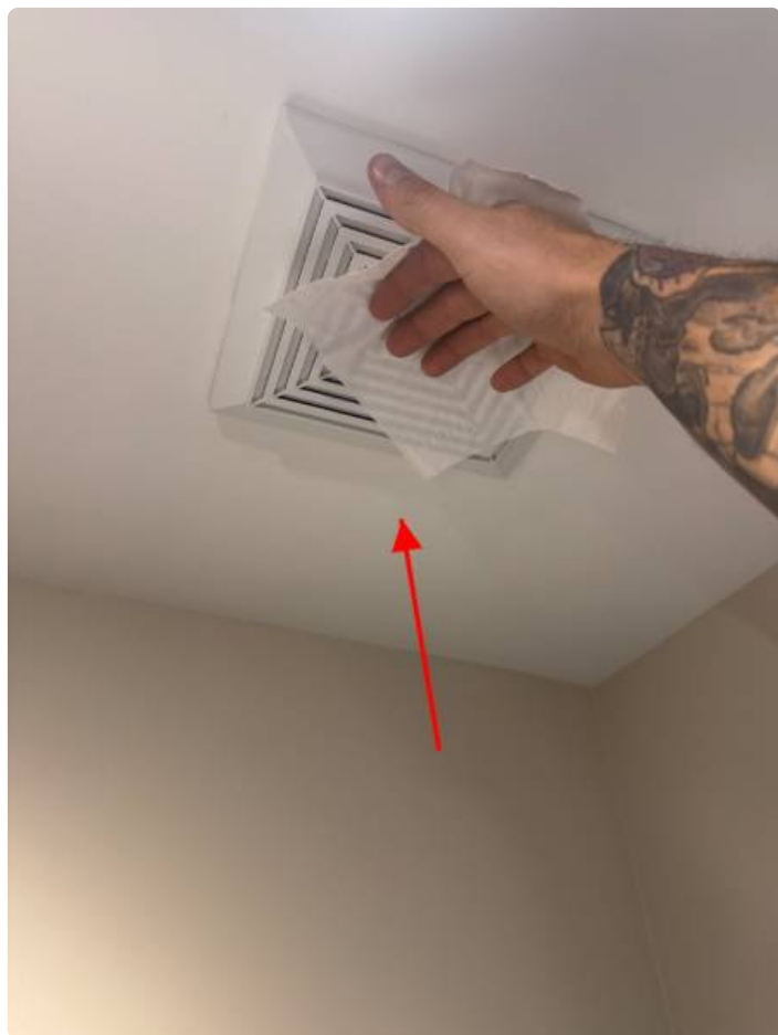
Tire de ventilation inadéquate.
