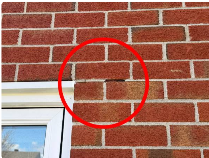
Signes de rouille sur le linteau
