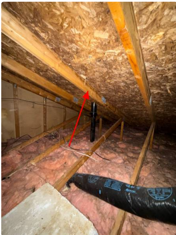
Signe d'infiltration d'eau dans le comble
