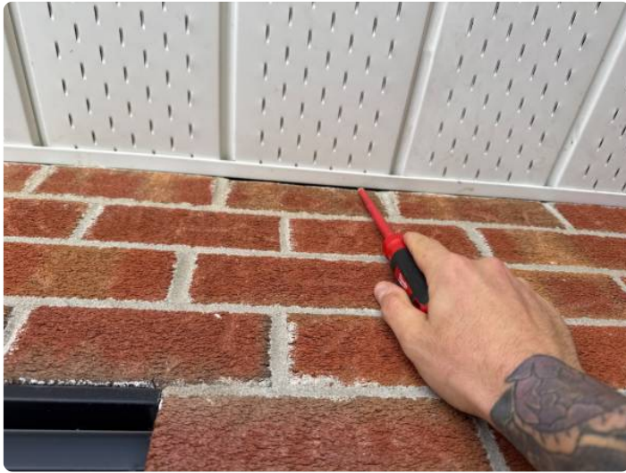
Ouverture entre le revêtement extérieur et le soffite.
