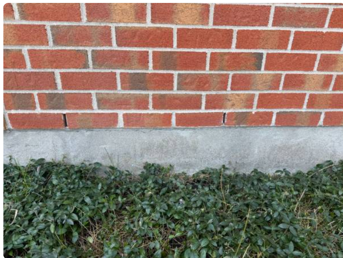
Fissures et dégradation du crépi sur la façade avant
