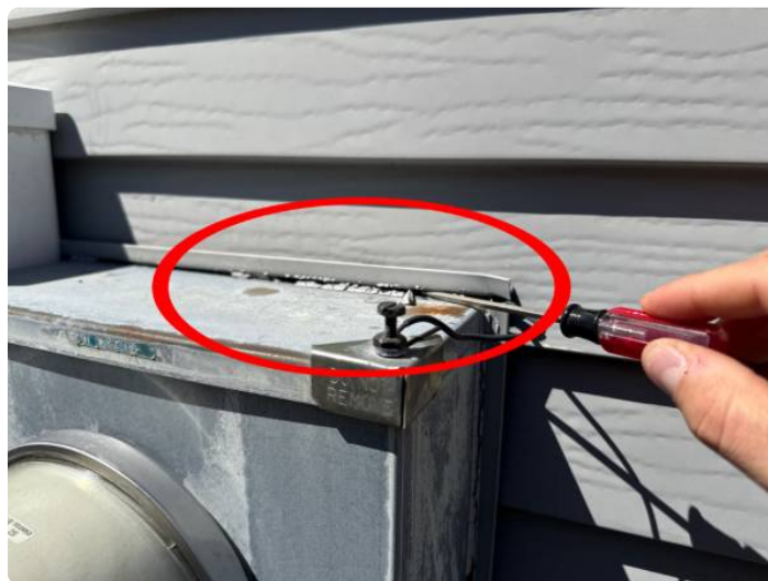
Calfeutrage autour du compteur électrique à reprendre
