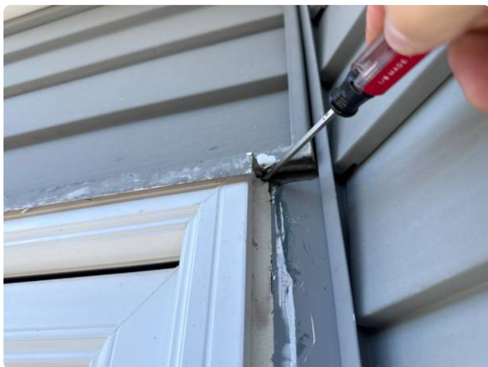
Calfeutrant fissuré et séché
